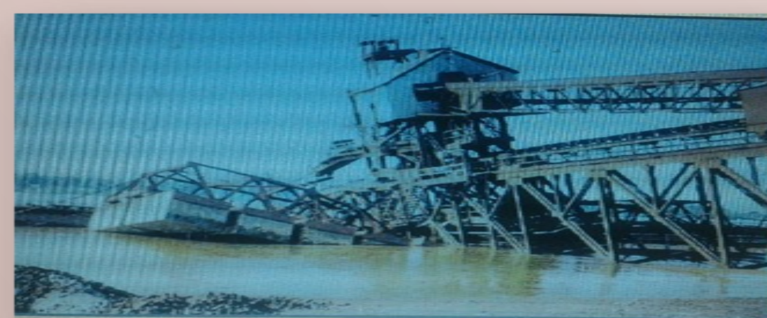
Danos na estrutura flutuante que suportava o carregador dos navios. Acesso: 10/12/15. fonte: Relatório de regulação 2014.
